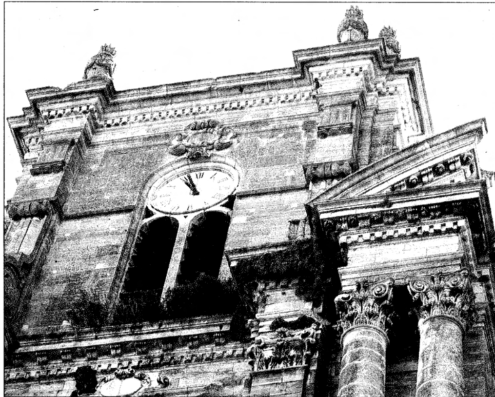
Les volatiles participent à la prolifération de végétaux dans les entablements de l'édifice.
